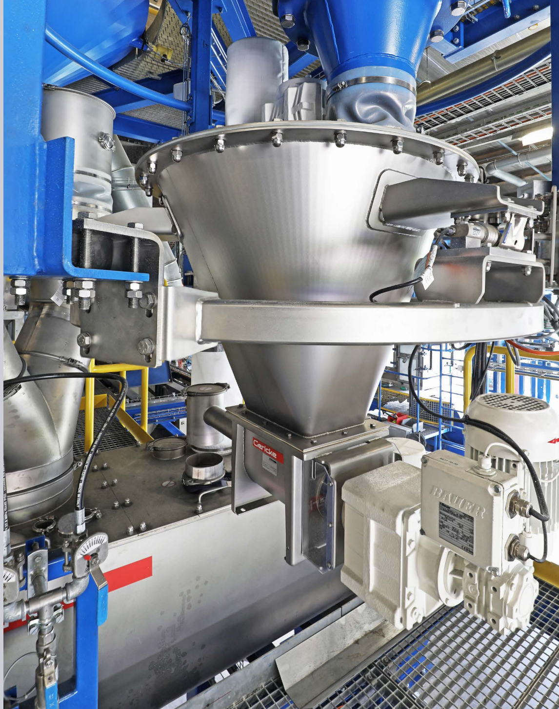
Instalação em uma fábrica de produtos químicos para construção (processo de mistura contínua).
